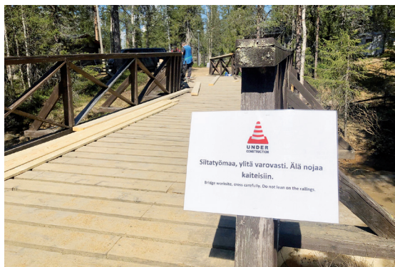
Hopiaojan ylittävän sillan kaiteista osa kaipasi kipeästi korjausta.
